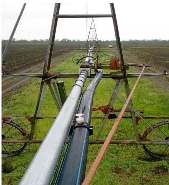
Рисунок 2.3 – Основной полиэтиленовый трубопровод с установленными седелками и дождевальными насадками
